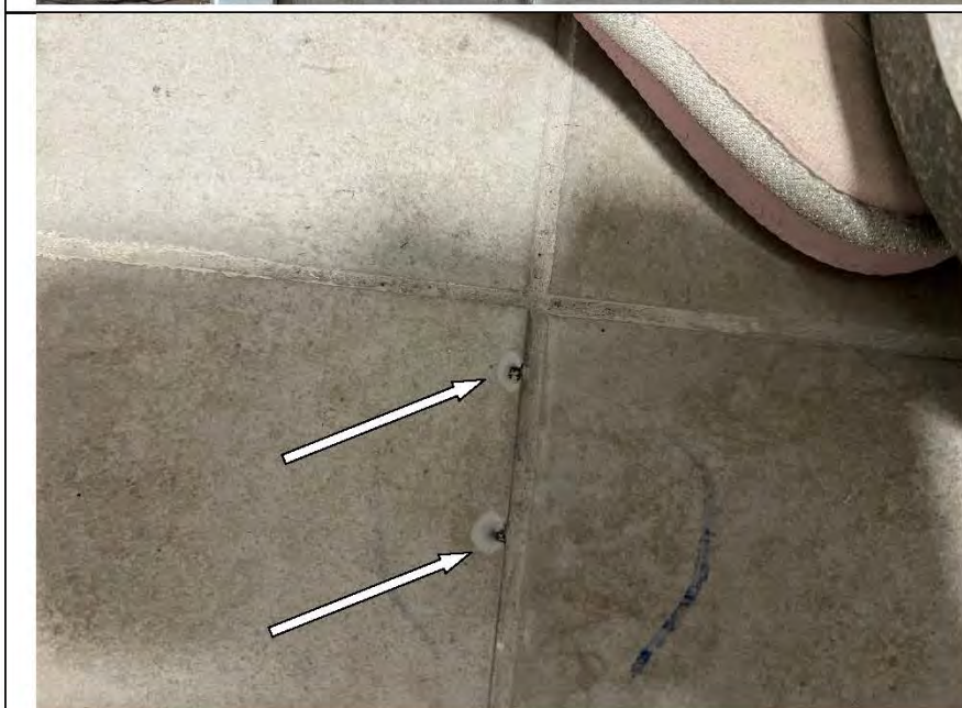
Фото №21. Отбитости напольной керамической плитки в коридоре.
