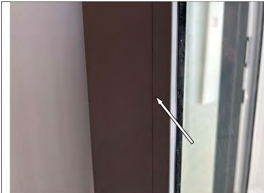
Фото №34. Механическое повреждение (царапина) профиля оконного блока ПВХ в спальне.
