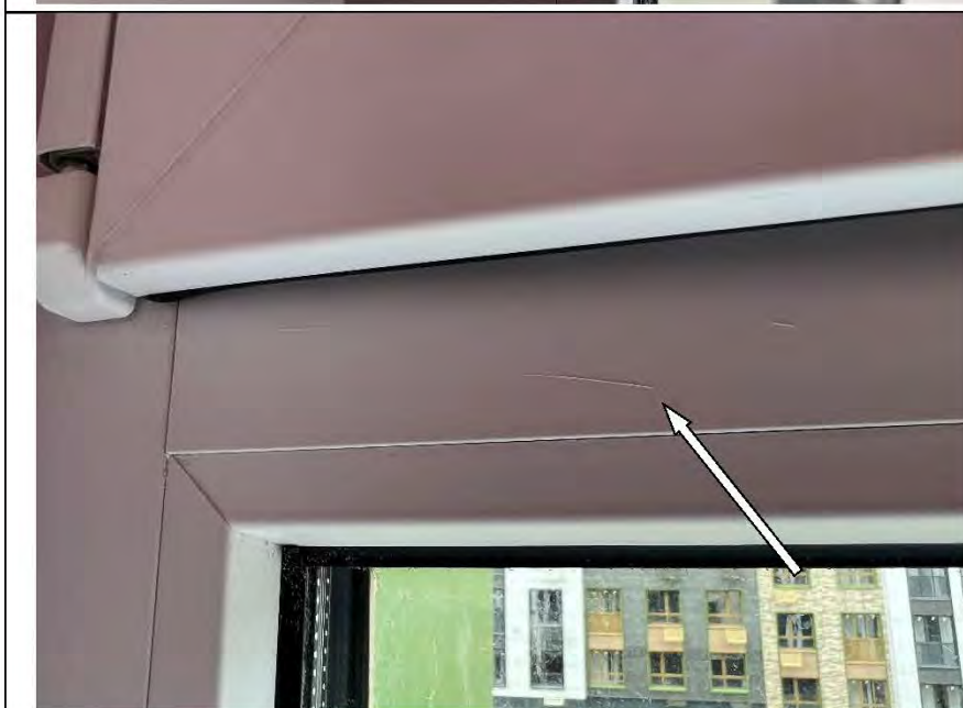
Фото №35. Механическое повреждение (царапина) профиля оконного блока ПВХ в кухне.
