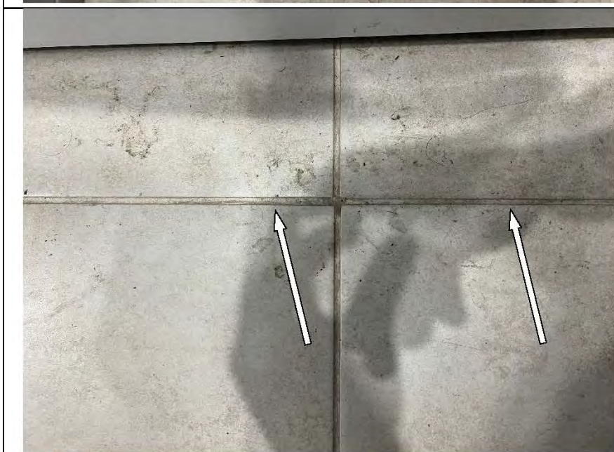
Фото №24. Разная толщина швов напольной керамической плитки в ванной комнате.
