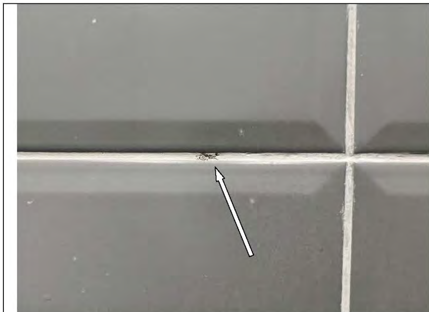
Фото №13. Пропуски затирочного раствора в швах настенной керамической плитки в ванной комнате.
