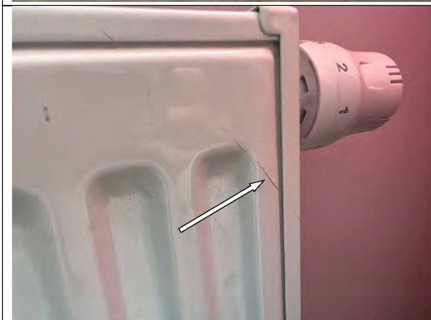
Фото №50. Механические повреждения (царапины) радиатора в кухне.
