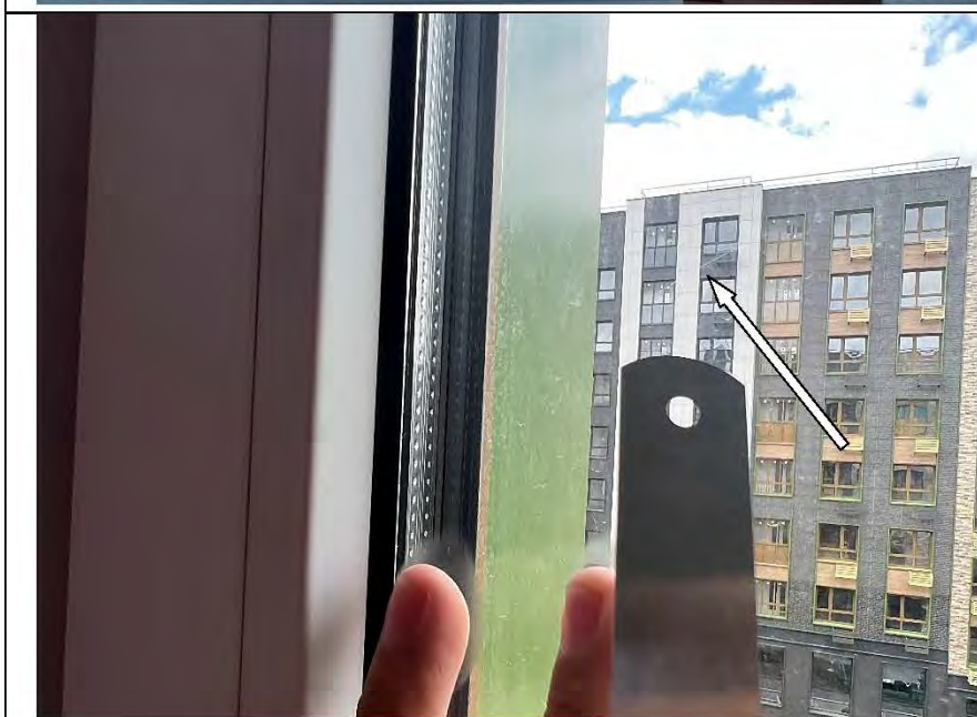
Фото №33. Царапины на стеклопакете оконного блока ПВХ в кухне.
