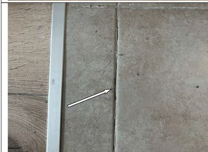
Фото №20. Пропуски затирочного раствора в швах напольной керамической плитки в коридоре.
