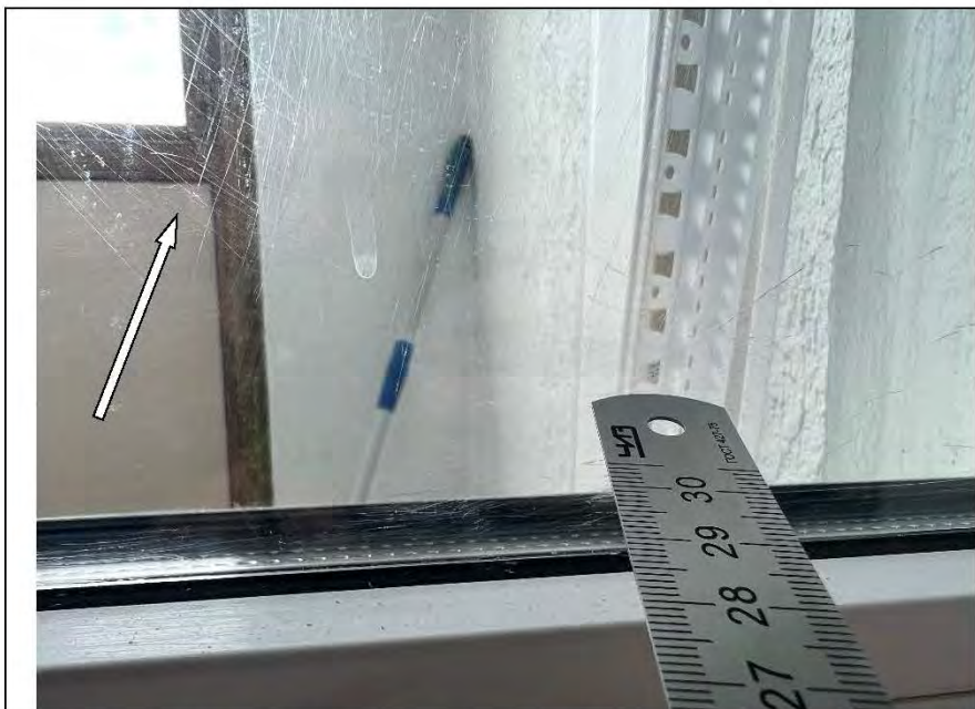
Фото №31. Царапины на стеклопакете оконного блока ПВХ в спальне.
