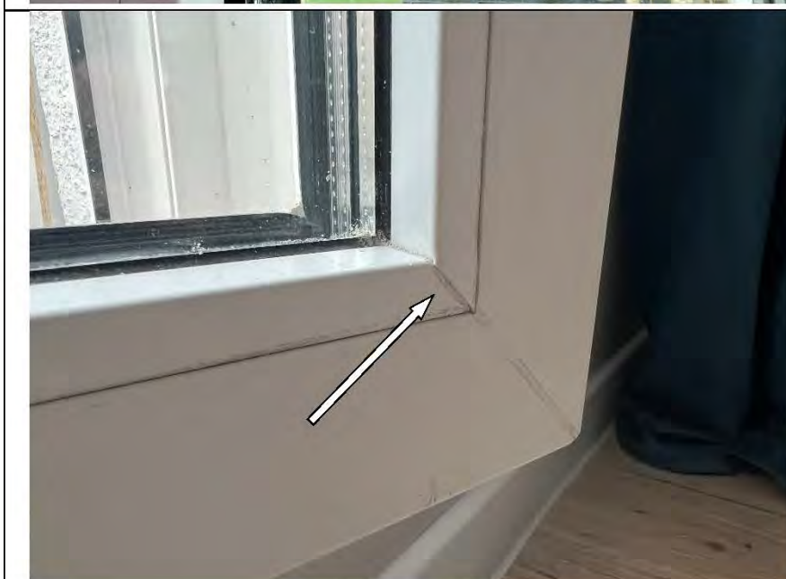
Фото №36. Зазоры в стыках профилей оконного блока ПВХ в спальне.
