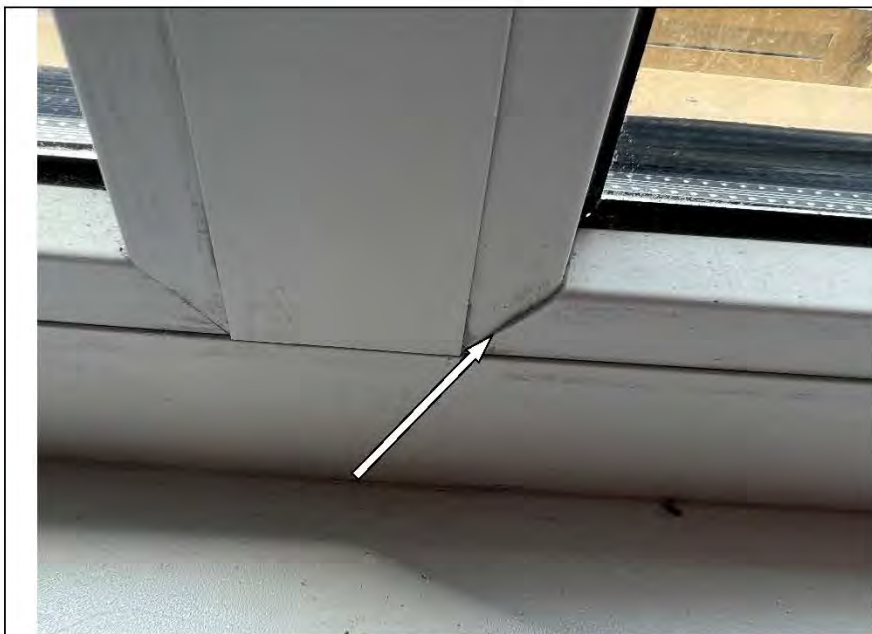
Фото №37. Зазоры в стыках профилей оконного блока ПВХ в кухне.
