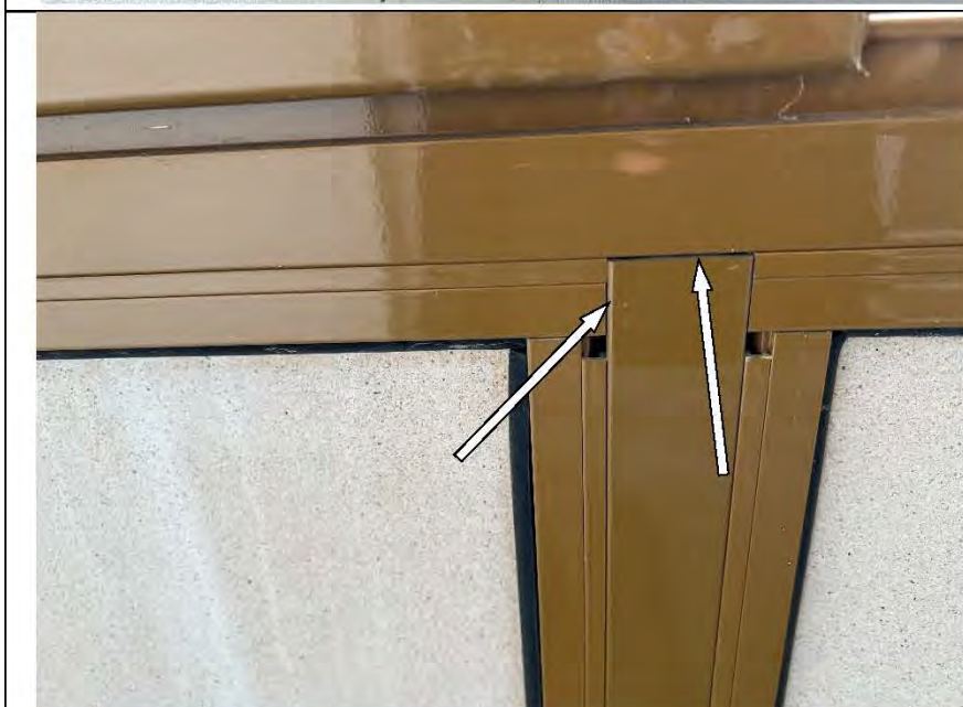
Фото №38. Зазоры в стыках металлических профилей оконного блока на лоджии.
