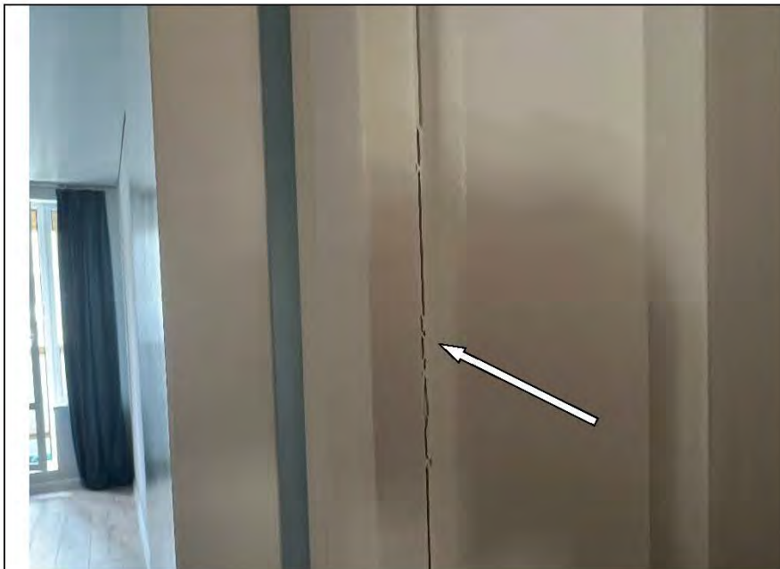
Фото №43. Элементы дверного блока в спальне соединены не надежно.
