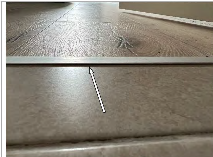
Фото №49. Зазор в стыке металлического порога и напольной керамической плитки в коридоре.
