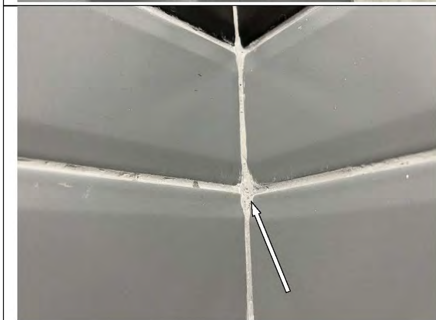
Фото №15. Наплывы раствора в швах настенной керамической плитки в ванной комнате.
