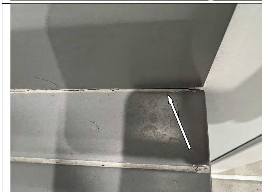
Фото №14. Трещина по шву настенной керамической плитки в ванной комнате.
