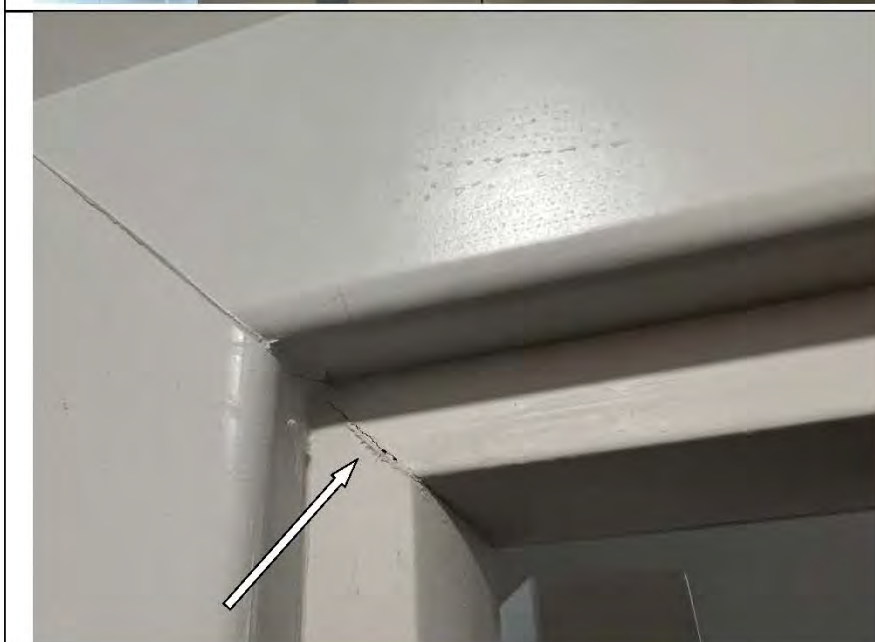
Фото №44. Элементы дверного блока в гардеробной соединены не надежно.
