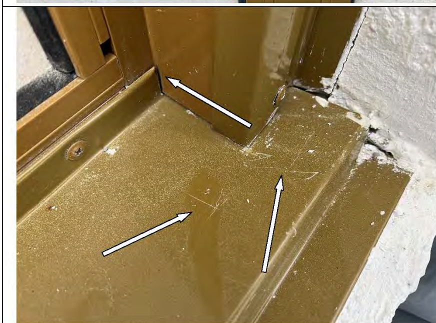
Фото №39. Механическое повреждение (царапины) на металлическом профиле оконного блока на лоджии. Зазоры в стыках металлических профилей оконного блока на лоджии.
