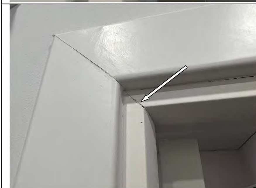
Фото №45. Элементы дверного блока в ванной комнате соединены не надежно.
