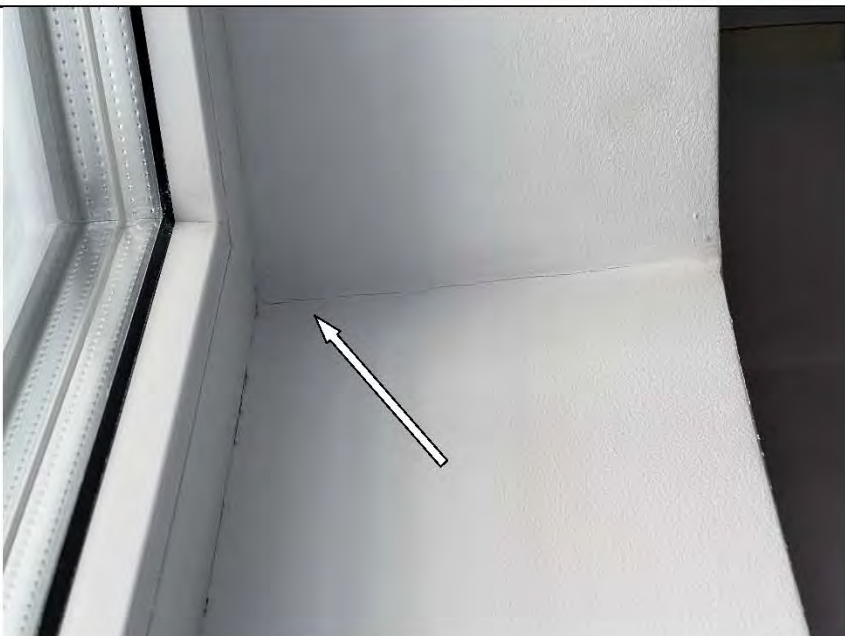
Фото №27. Трещина по отколу оконного блока ПВХ в спальне.
