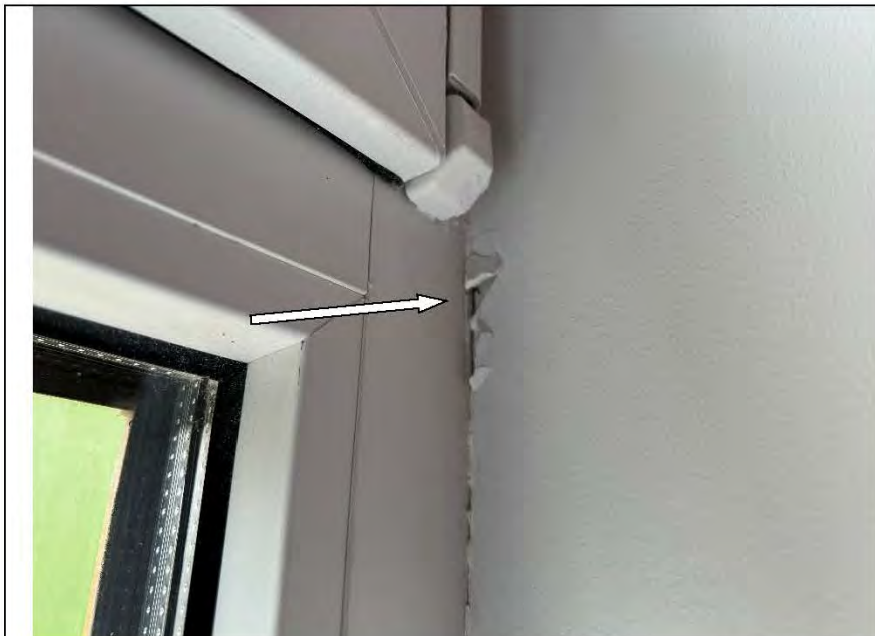
Фото №28. Отслоение отделочного слоя откоса оконного блока ПВХ в кухне.
