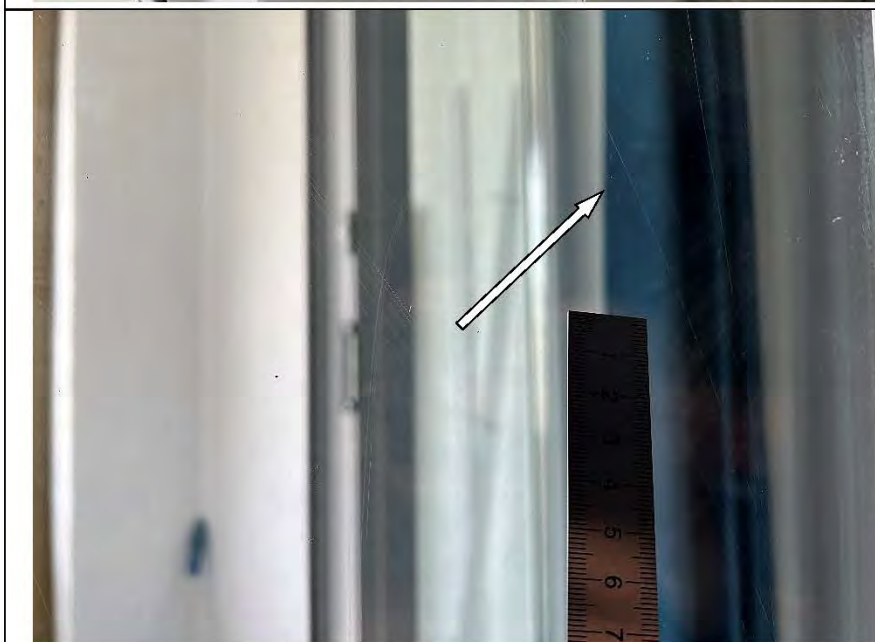
Фото №30. Царапина на стеклопакете оконного блока ПВХ в спальне.
