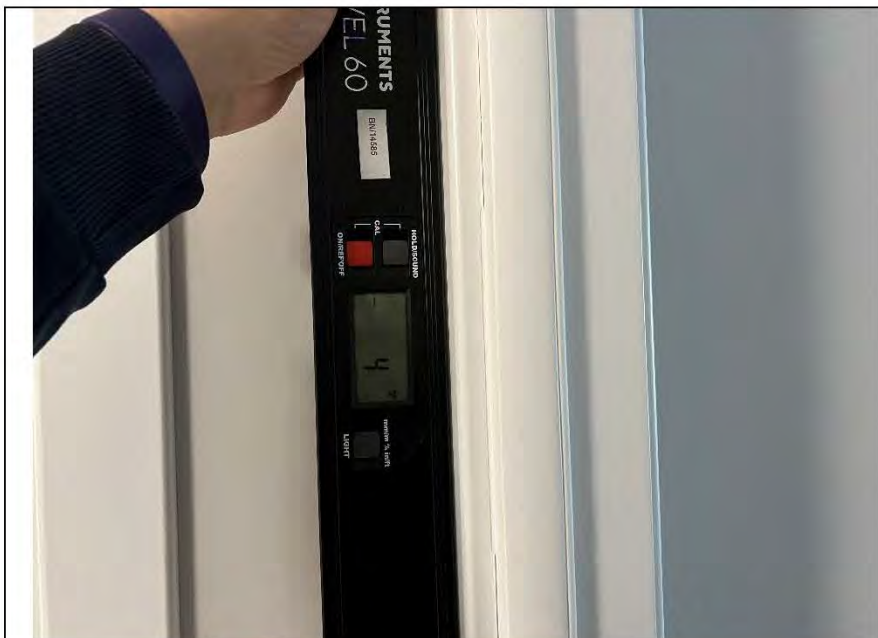
Фото №40. Отклонение наличников дверного блока в спальне равно 4 мм.
